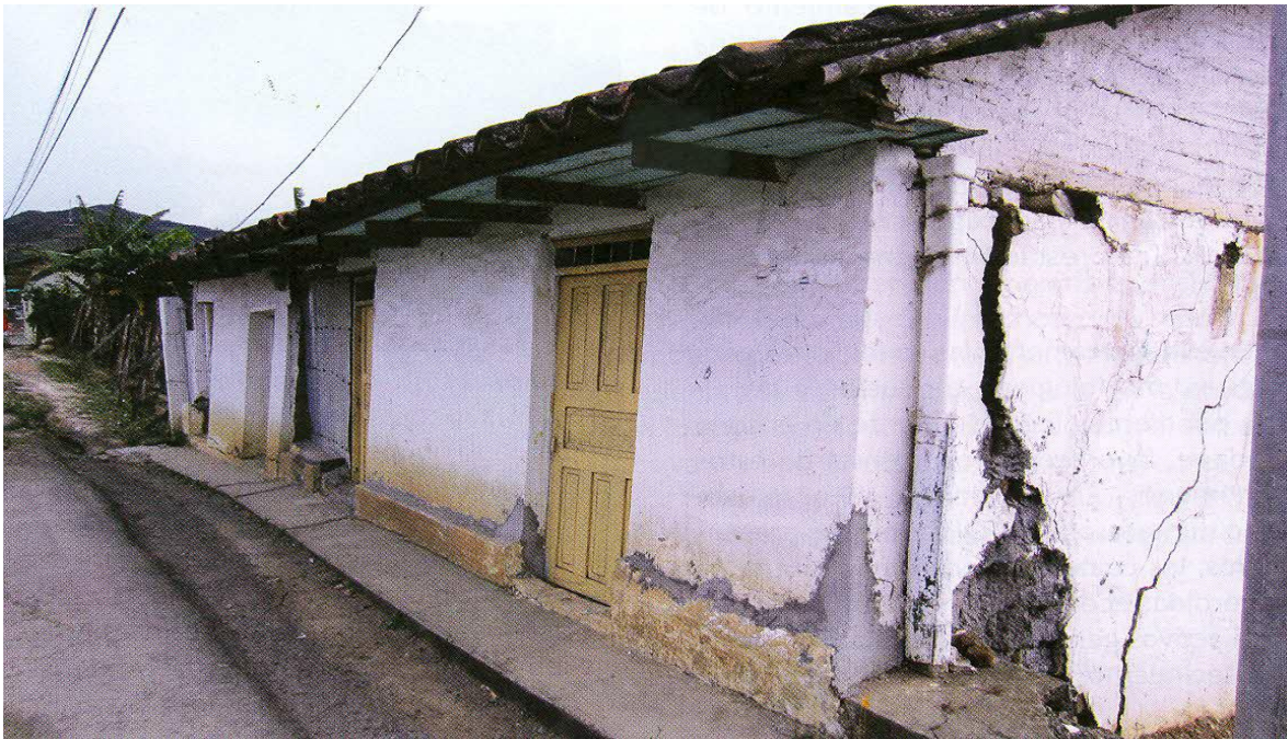
Figura 20. Vivienda afectada por movimientos de masa, municipio de Buesaco
