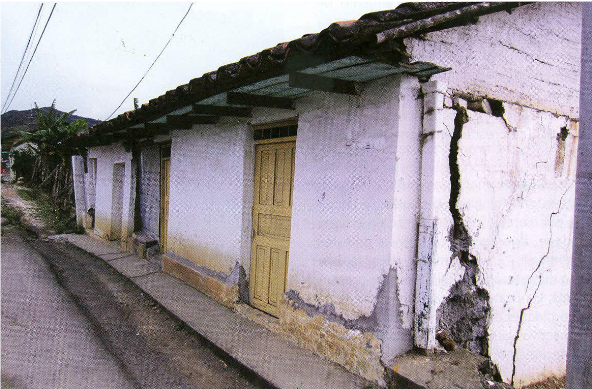
Figura 20. Vivienda afectada por movimientos de masa, municipio de Buesaco
