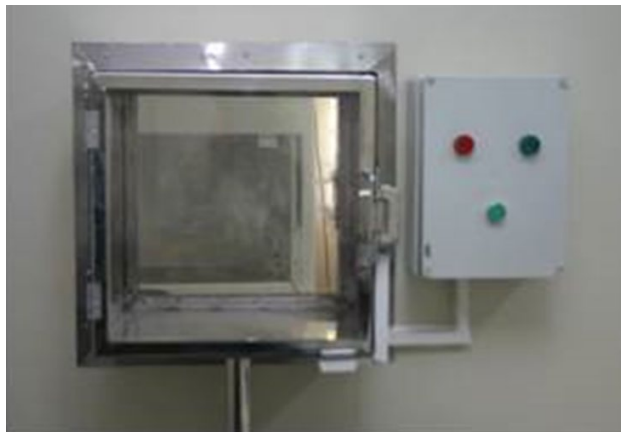
Pass through, para el ingreso/egreso de material que no puede ser autoclavado
